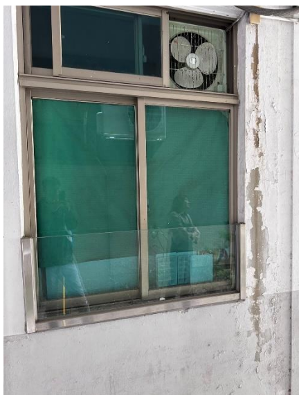
實習教室牆壁剝落
